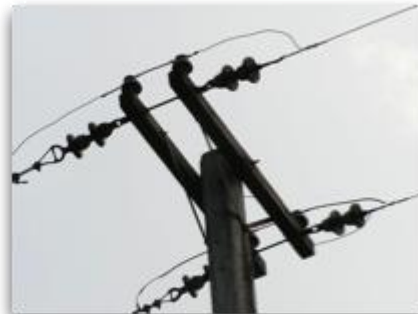
Sloup elektrického vedení má na sobě vodiče i izolátory.
